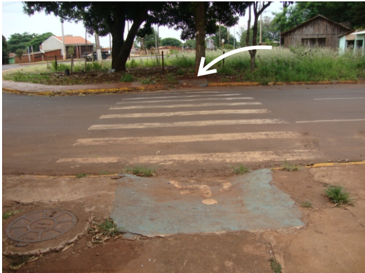
Rampas sem manutenção.
