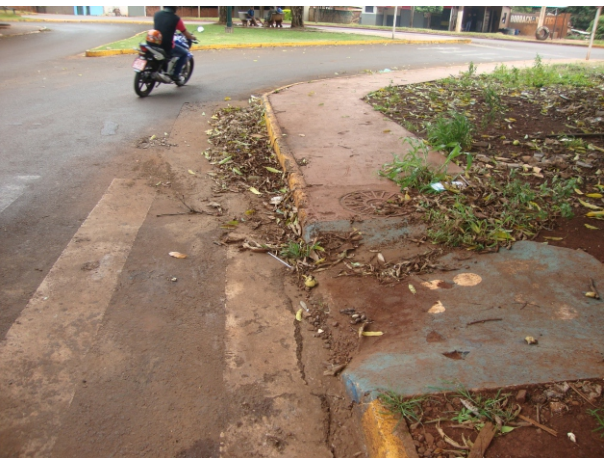
Falta de manutenção da sinalização e excesso de folhas, dificulta o uso da rampa, prejudicando a acessibilidade.
