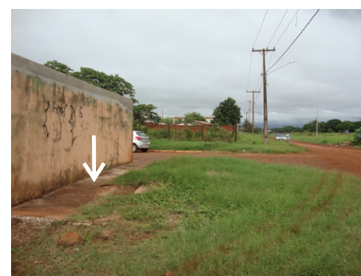
Calçada sem pavimentação e vegetação sem manutenção avança sobre o passeio e a via.
