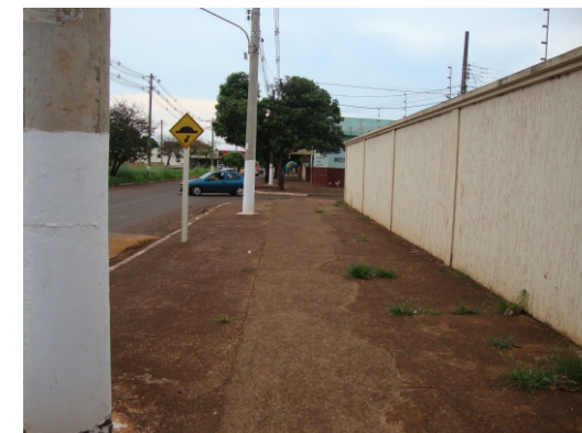
Calçada sem piso podotátil e rampas para PNEs.
