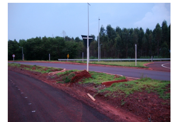
Falta de manutenção da rede pluvial compromete a qualidade da ciclovia.
