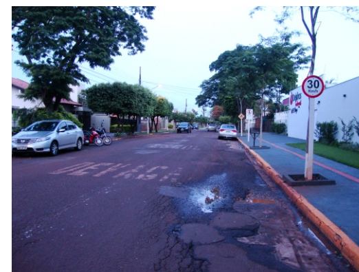
Calçada em bom estado e com piso podotátil, fica comprometida com a baixa condição da pista de tráfego.
