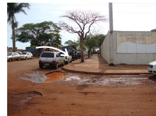
Calçada sem acessibilidade universal, além de buracos perigosos na área de travessia.
