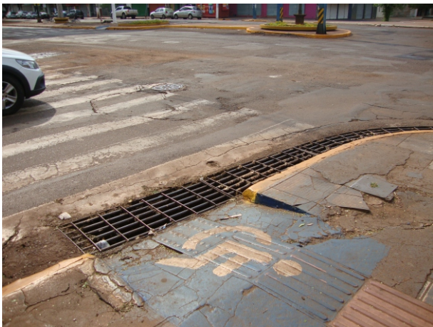
Grelha de coleta pluvial com grandes vãos expõe o pedestre a risco e dificulta o movimento do cadeirante.
