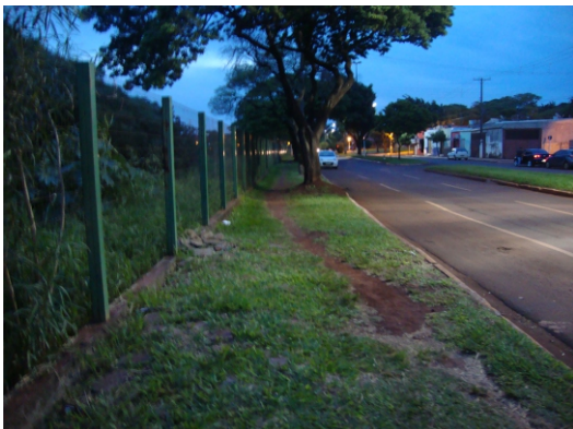
Passeio no entorno do parque sem pavimentação.
