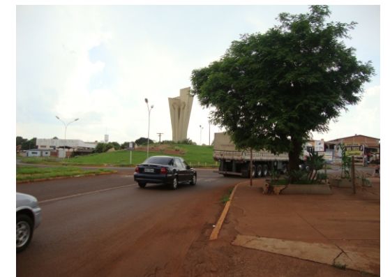
Degrau entre calçada e meio fio aliado, ao canteiro improvisado compromete o deslocamento na calçada.
