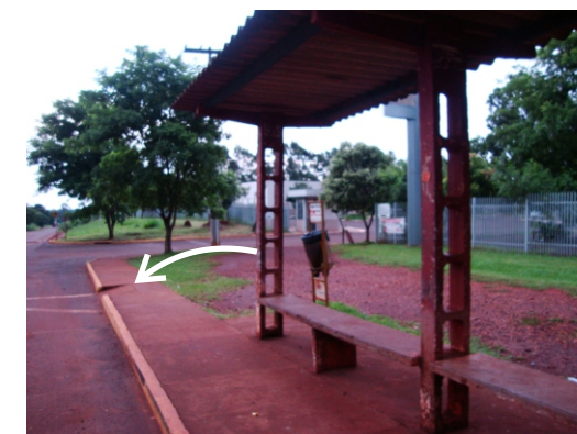
Abrigo de ônibus mal conservado e rampa de PNE sem correspondência ou continuidade.
