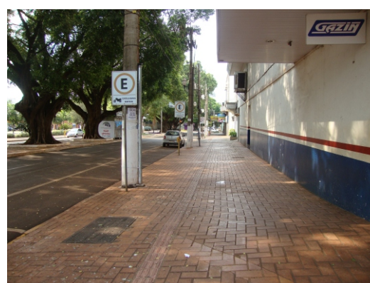
O tipo de pavimento confunde-se no contato com o piso podotátil.
