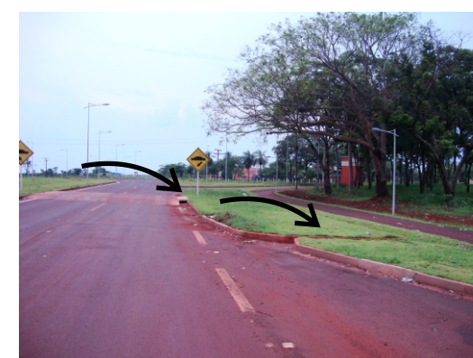
A falta de pavimentação e a presença de elementos de drenagem.
