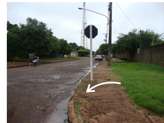
Ausência de rampas para PNE.
