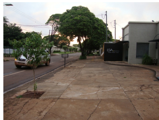
Rebaixo de meio fio depreda o passeio e favorece apenas o estacionamento de veículos na área da calçada.
