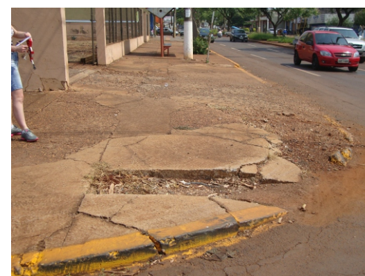
Buracos na calçada oferecem um grande risco ao pedestre.
