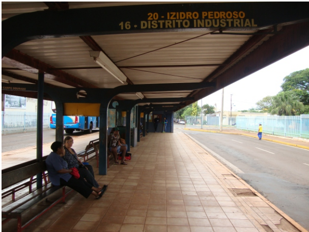
Utilização de piso liso, sem manutenção e ausência de piso tátil.
