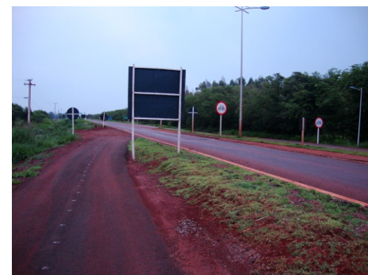
Ausência de sinalização de travessia segura para ciclistas.
