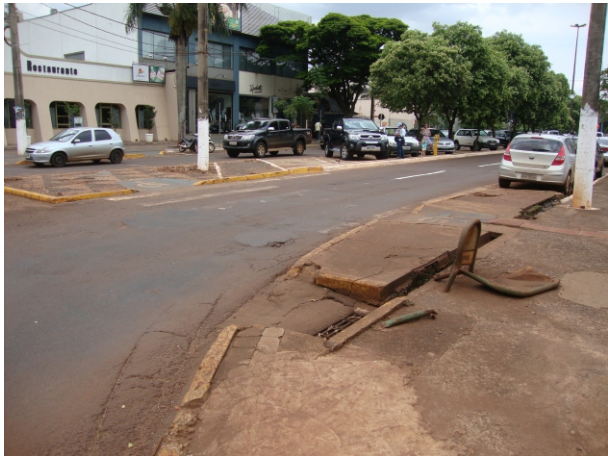
Falta de grelha protetora sobre as drenagens causando risco de lesão aos usuários.
