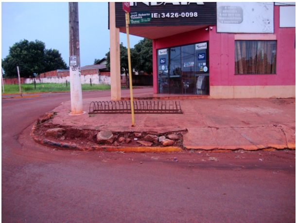
Desconformidade nas esquinas expõem o pedestre a riscos e impossibilita a travessia segura de PNEs.
