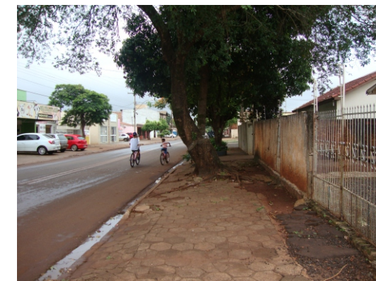
Raízes deformando a pavimentação desqualificam a calçada.
