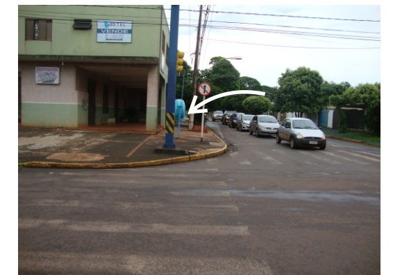
Calçada sem manutenção, sem rampa de acessibilidade, sem piso podotátil e mobiliário urbano distribuído de forma irregular sobre o passeio.
