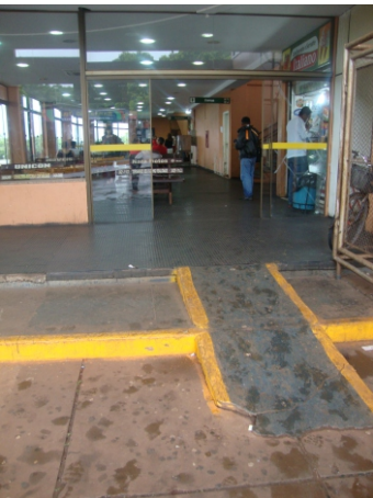
Rampa de acesso como solução pontual, porem sem correspondência na área externa.
