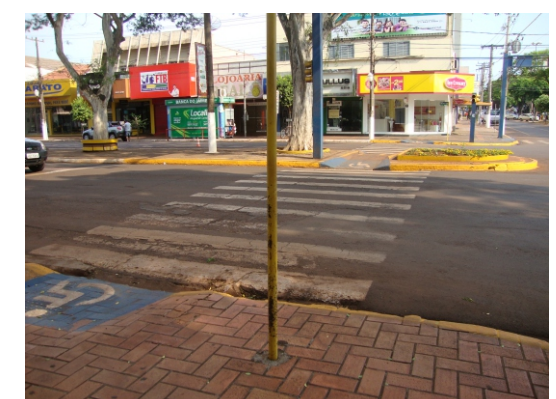
A qualidade da pintura das faixas de pedestres influencia na qualidade e percepção ambiental do cruzamento .
