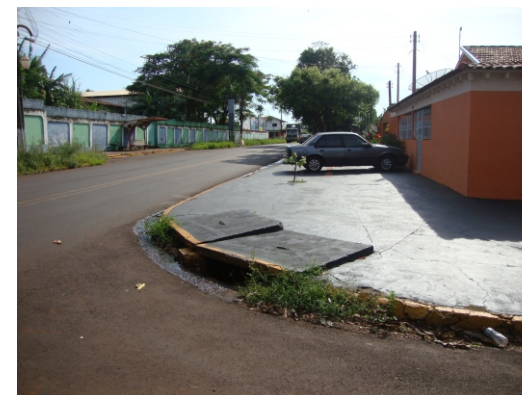
Boca de lobo formando um degrau na calçada e automóvel bloqueando a circulação.
