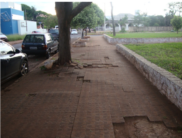
Deformidade do pavimento provocada pelas raízes das árvores e falta de manutenção.
