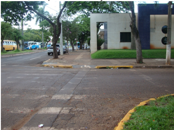
Má conservação da pavimentação, sinalização e rampas no acesso a unidade de saúde.
