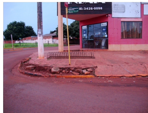
Deterioração da calçada na esquina do cruzamento oferece risco ao pedestre.
