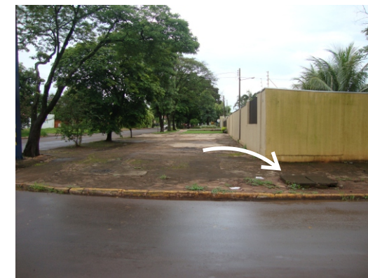
Calçada sem elementos de acessibilidade e com alguns obstáculos ao longo do caminho.
