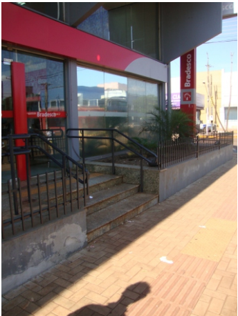
Apesar do encaminhamento da sinalização tátil, ausência de rampa torna o prédio inacessível a cadeirantes.
