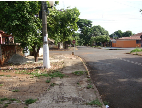
Calçada com planicidade comprometida e material de obras faz do local insalubre.
