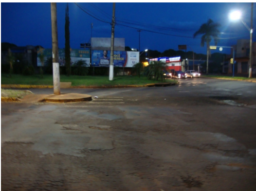
Falta de manutenção da pintura da faixa de segurança.
