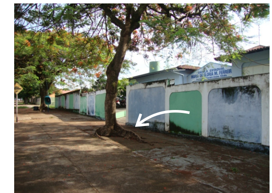
Raízes de árvores aparentes no acesso da escola podem causar acidentes, além da pavimentação comprometer a saúde da própria árvore.
