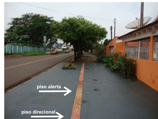
Piso podotátil colocado em desconformidade com a Norma, e confusão no uso do piso de alerta.
