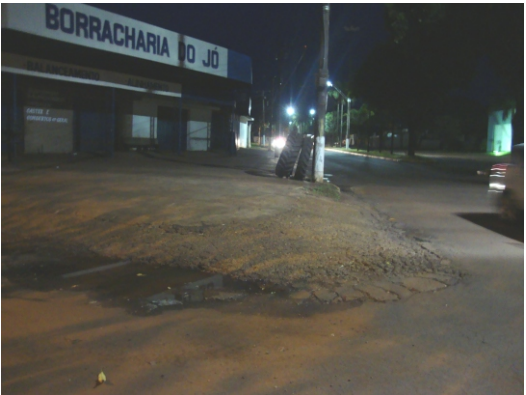
Calçada em mal estado de conservação com rebaixo de meio fio em ambas as testadas e insuficiência de iluminação pública compromete a segurança.
