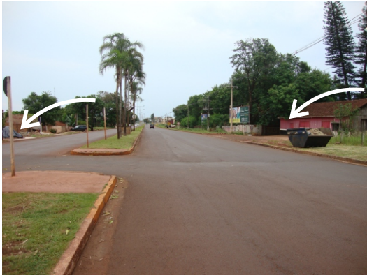
Falta de pavimentação ao longo do passeio público e presença de caçamba de detritos que dificultam o deslocamento de pedestres.
