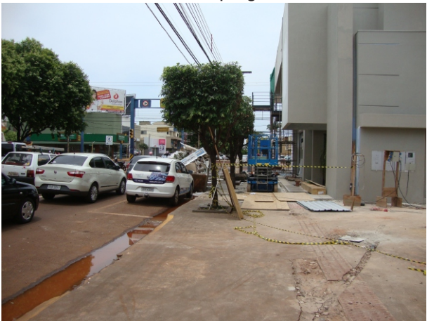
Obstrução e ocupação inadequada da calçada bloqueia totalmente a circulação dos pedestres.
