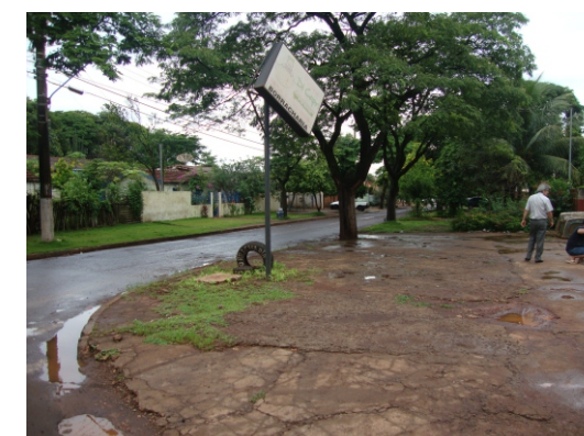
Falta de manutenção do pavimento e do mobiliário urbano apresentam risco aos pedestres.
