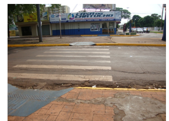
Rampas de acessibilidade em conformidade com a Norma, porém falta manutenção da calçada e da pavimentação da pista no bordo junto ao meio fio.
