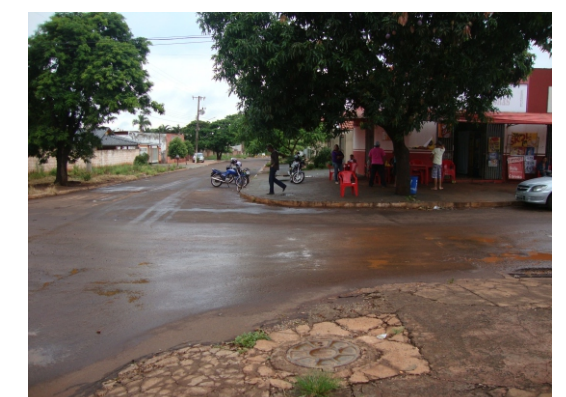
Calçadas sem pavimentação, sem manutenção e sem acessibilidade.
