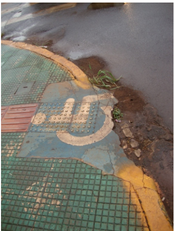
A desconformidade da rampa prejudica o deslocamento acessível.
