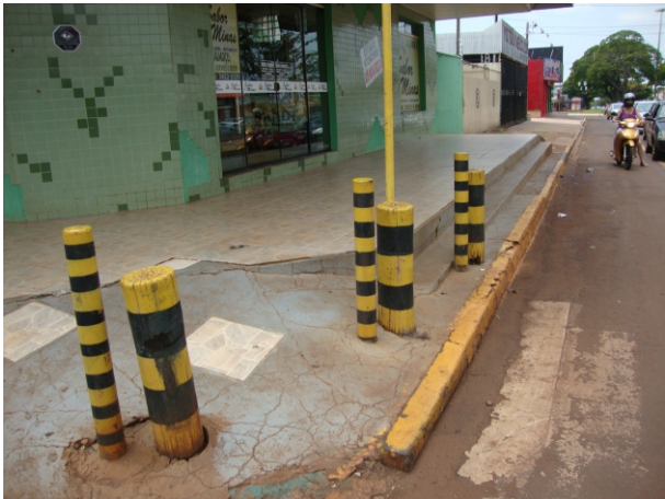
Obstáculos dificultando o acesso ao passeio através do rebaixo, e desníveis.
