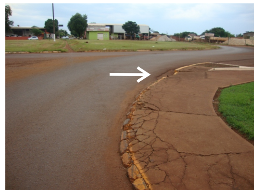
Degrau entre rampa de PNE e o leito carroçável, aliado a deterioração do pavimento traz riscos aos pedestres.
