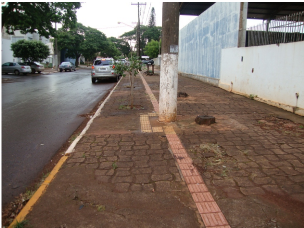
Piso podotátil implantado em faixa inadequada do passeio, além de conter obstáculos.
