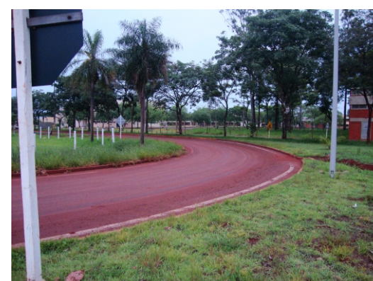
Ausência de faixa de segurança e passeio público.
