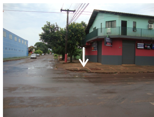
Degradação da pavimentação das esquinas traz riscos aos pedestres.
