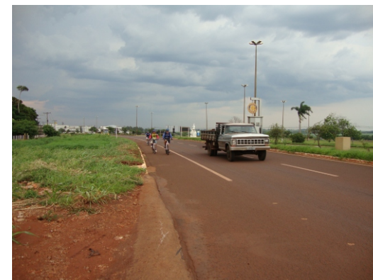
A falta de calçada e via ciclável, faz com que ciclistas e pedestres circulem pelo acostamento.
