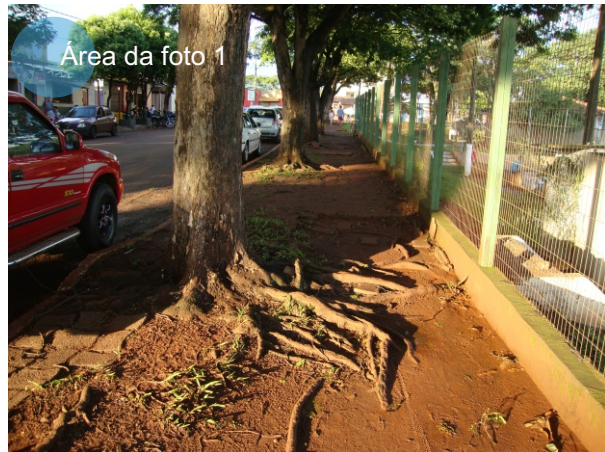
Calçada ao redor do parque oferecendo risco ao pedestre.
