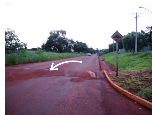
Falta de manutenção na pintura da lombada e área de passeio para pedestres.
