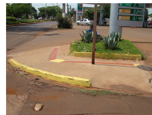
Rampa em desconformidade com a norma e piso podotátil sem continuidade.
