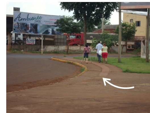
Piso podotátil sem continuidade de indicação de alerta junto a local com saída de veículos.
