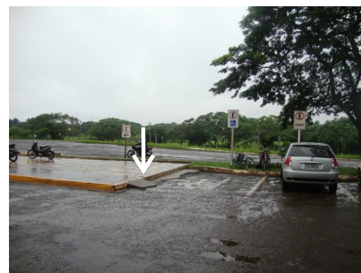
Rampa em desconformidade com a norma.
