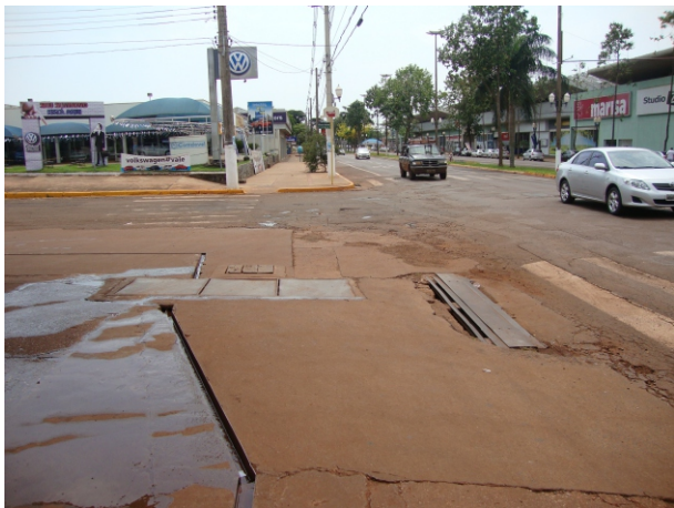
Rebaixo de meio fio contínuo e ininterrupto nas duas testadas reduz a proteção ao pedestre.
