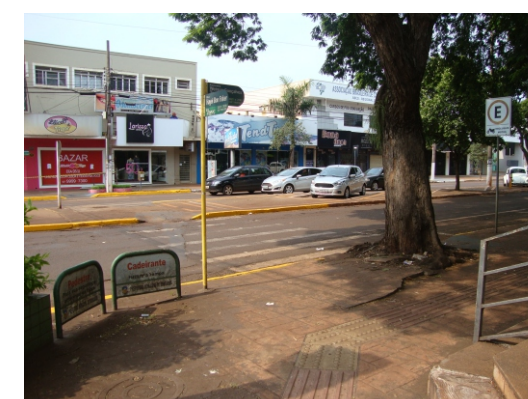
Pavimento prejudicado pelas raízes da árvore.
