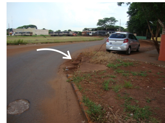
Falta continuidade da pavimentação da calçada e bueiro sem manutenção trazendo risco ao pedestre.
