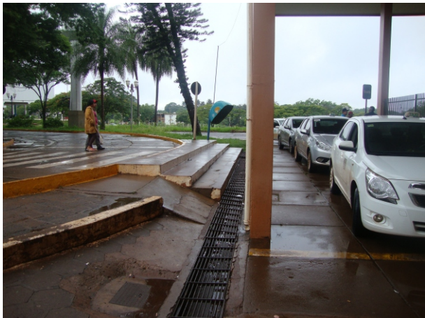
Incompatibilidades na execução dos elementos da calçada, consolidam obstáculos ao longo do acesso.
