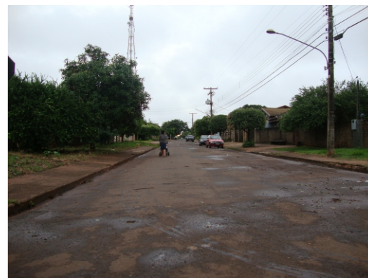
Falta de sinalização viária e atratividade da via.
