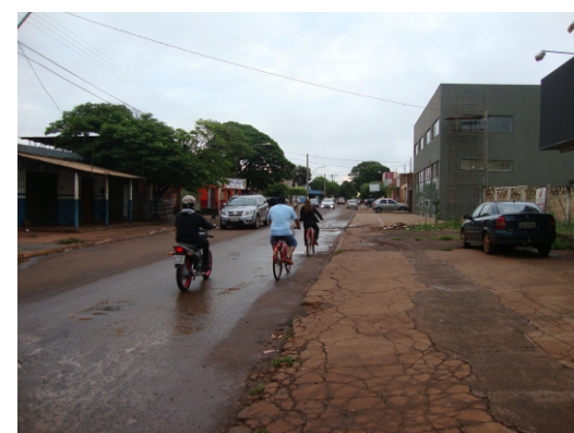
Veículos estacionados sob a calçada e a falta de manutenção expõe o pedestre a riscos.
