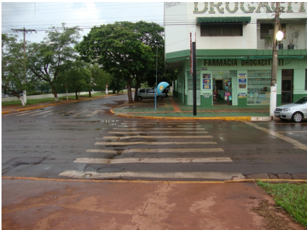
Travessia de pedestre sem rebaixo de meio fio não encontra correspondência com o piso podotátil da calçada.
