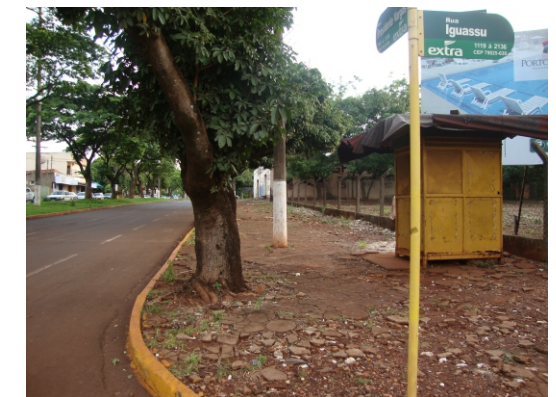
Calçada deteriorada torna perigosa a circulação de pessoas e prejudica a atratividade do trecho.
