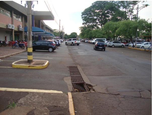
Grelha pluvial em péssimo estado de conservação comprometendo a segurança.
