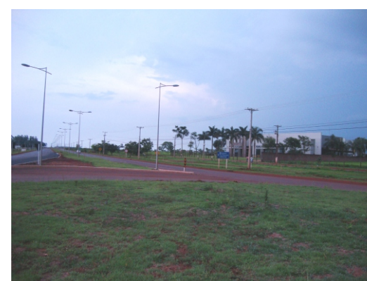
Falta de faixa de pedestre e sinalização específica, faz com que o cruzamento seja perigoso para os pedestres.
